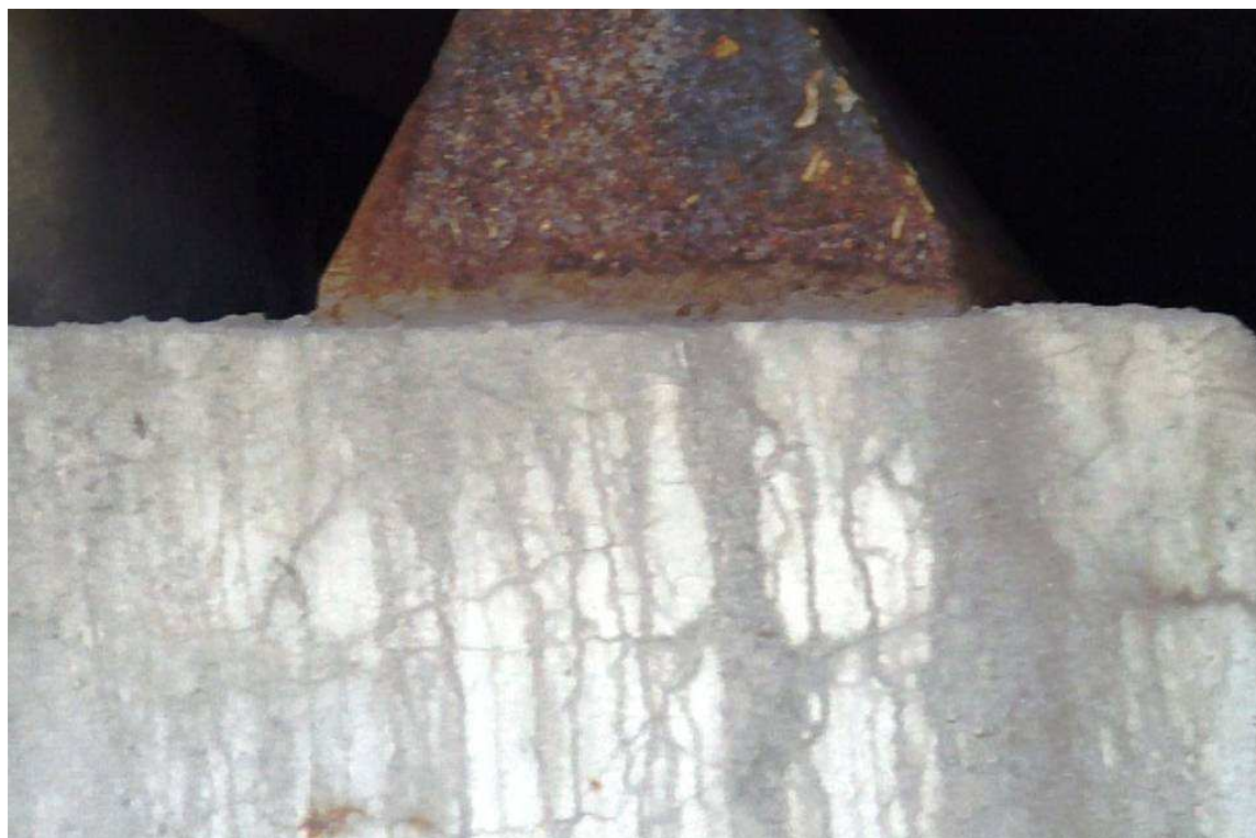
Fot. 38. Przegub Gerbera w przęśle 5-6. Powierzchniowa korozyja żyzyska. Spękania wierzchniej wyprawy z materiału PCC. Brak uszkodzeń konstrukcyjnych.
