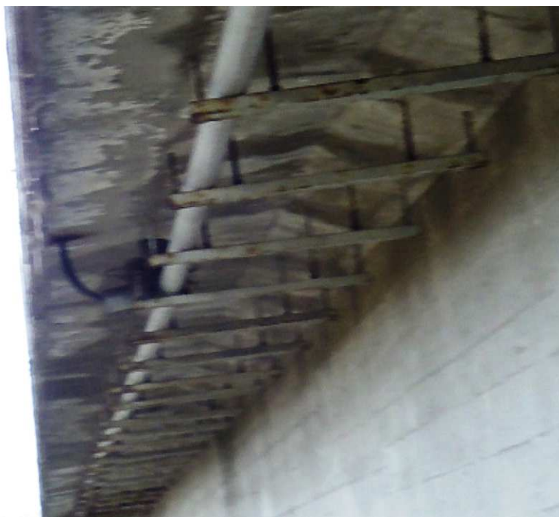
Fot. 30. Solne wykwity i stalaktyty oraz zacieki na spodzie wspornika chodnikowego w przęśle 5-6.
