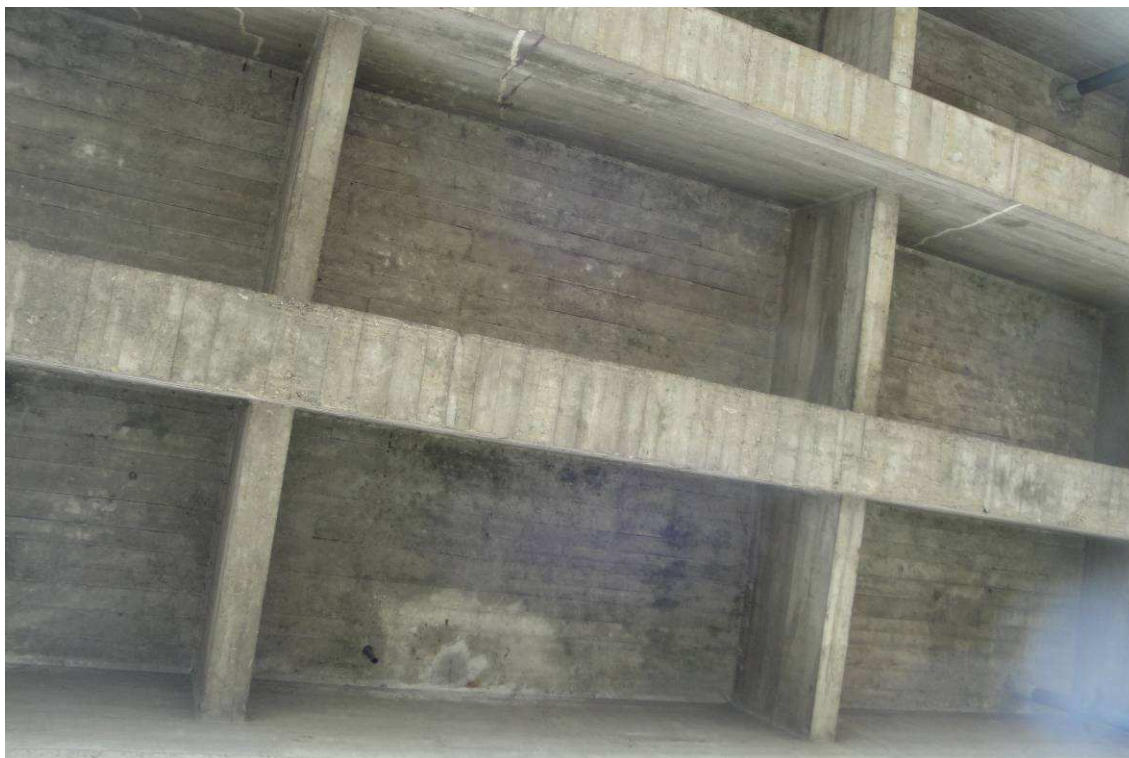
Fot. 20. Częściowo naprawione pionowe rysy w konstrukcji podwieszanej. Ślady przecieków przez płytę.
