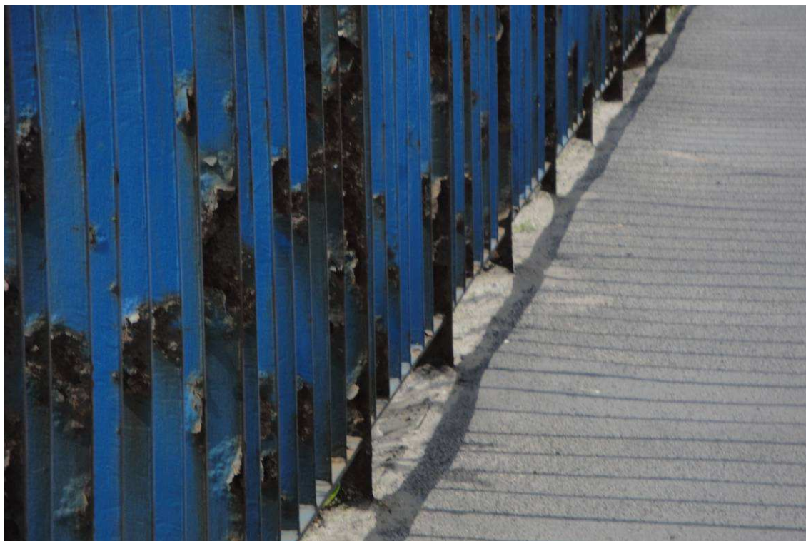
Fot. 15. Skorodowane szczelinki balustrady. Zakotwienie nieuszkodzone.
