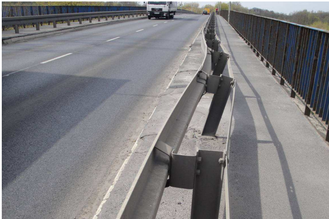
Fot. 19. Uszkodzona bariera ochronna na dojeździe od strony wschodniej.
