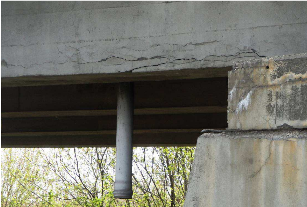
Fot. 31. Korozja zbrojenia powodująca rozsadzanie otuliny w belce skrajnej po stronie GW przy podporze 8.
