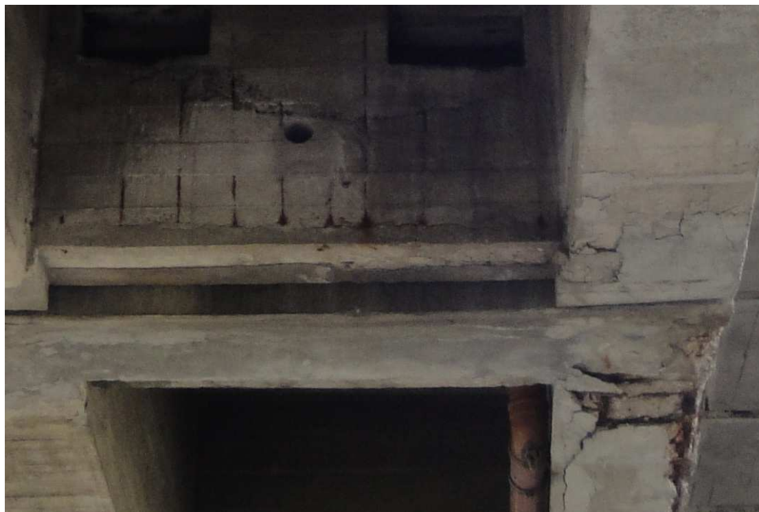
Fot. 23. Korozja odsłoniętego zbrojenia dźwigara oraz poprzecznicy w obrębie przegubu w przęśle 1-2. Korozja zbrojenia w obrębie przegubu nie została powstrzymana.
