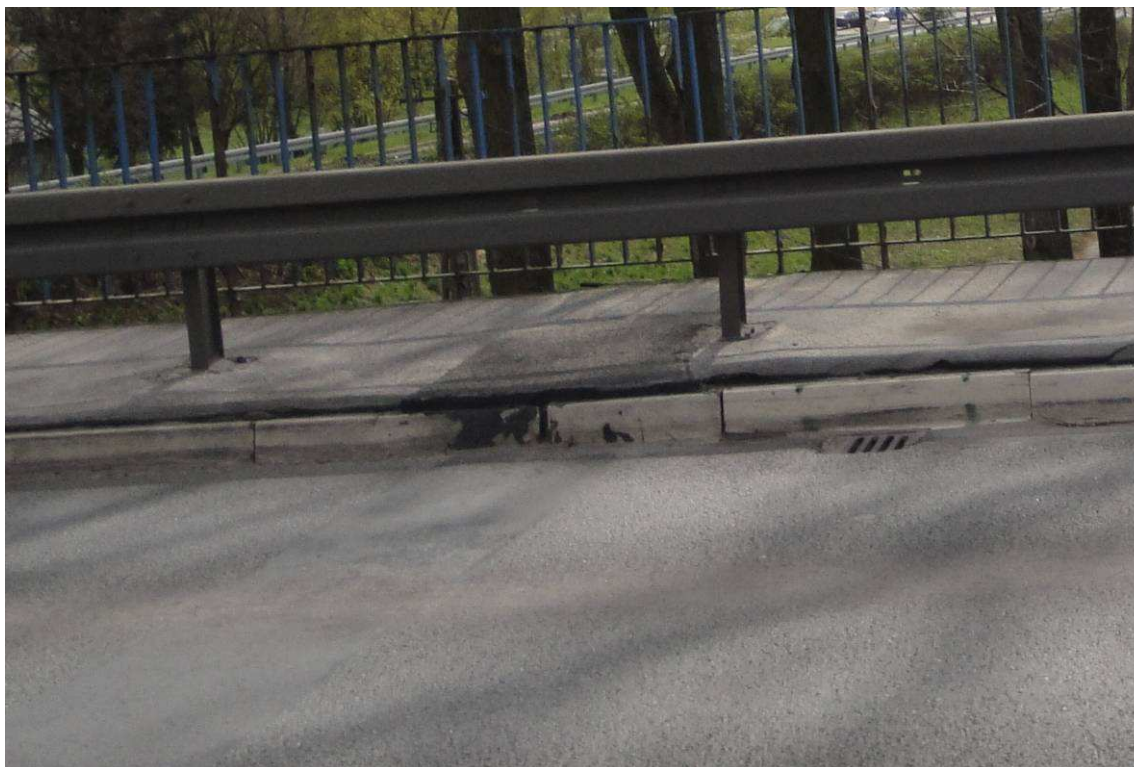
Fot. 10. Dobry stan nawierzchni i dylatacji bitumiczne . Pęknięty krawężnik nad dylatacją.
