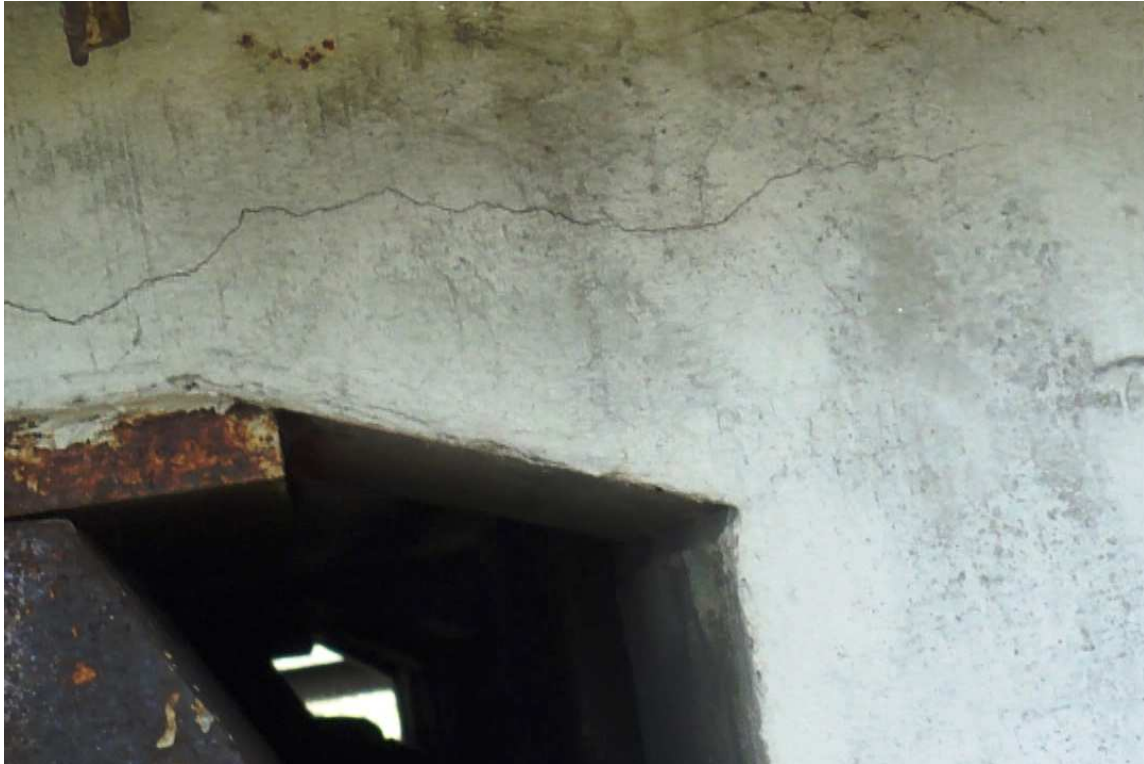
Fot. 39. Zarysowanie wyprawy PCC nad łożyskiem w przegubie. W głębi widoczna szczelina przegubu bez uszkodzeń mechanicznych i przecieków.
