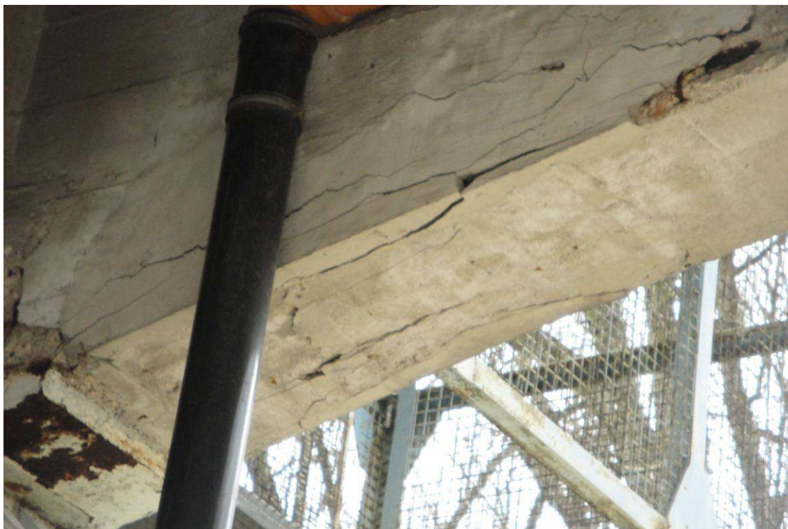
Fot. 27. Odspojenia zaprawy PCC wzdłuż głównych prętów dźwigara w strefie nad podporą 2. Korozja prętów zbrojeniowych nie została powstrzymana. Produkty korozji rozsadzają otulinę z zaprawy PCC.
