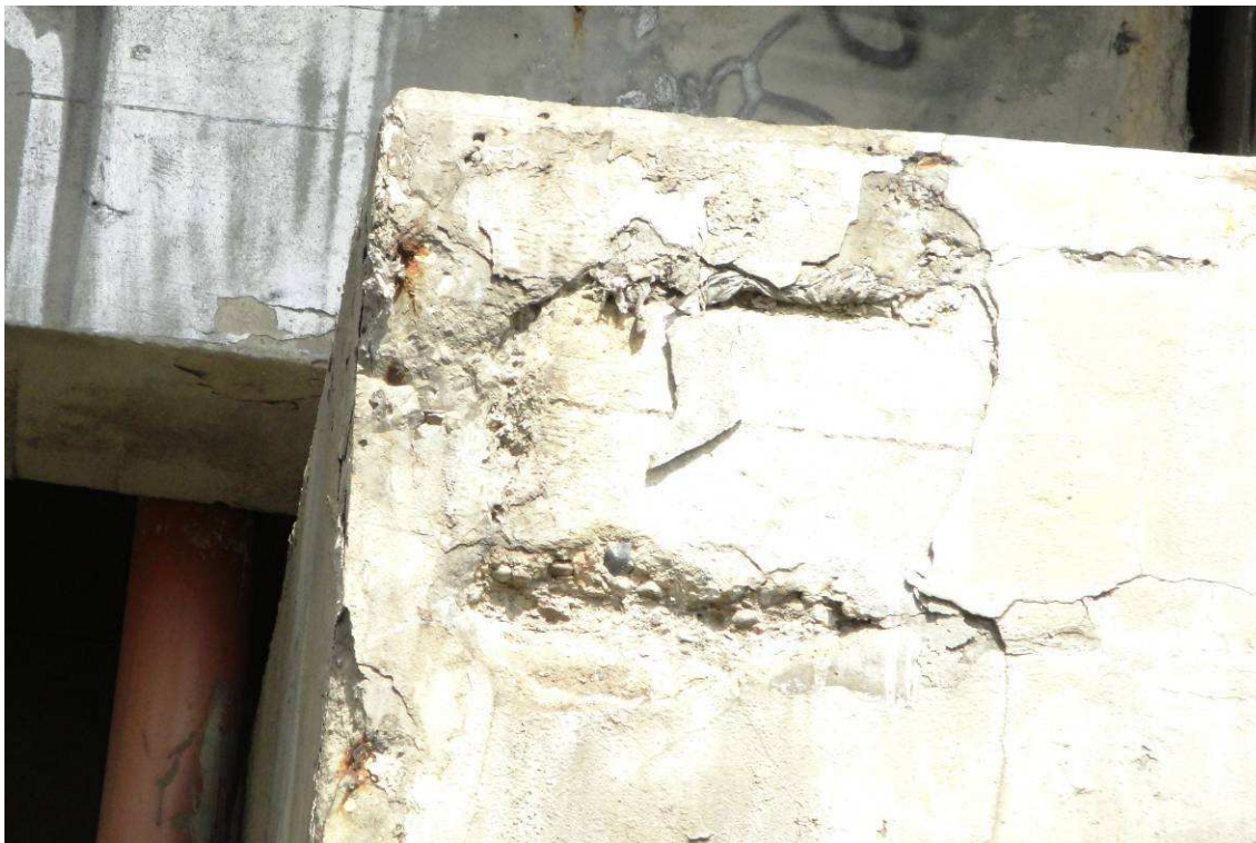
Fot. 33. Przyczółek wschodni. Odspojenia, spękania i ubytki betonu w obrębie ław podłożyskowych.
