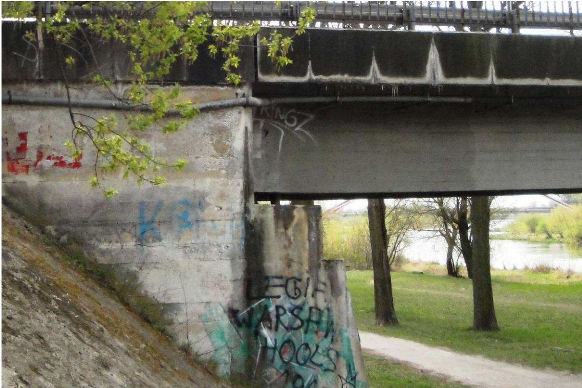
Fot. 35. Przymocowanie wschodni. Zawilgocenia, spękania i lokalne ubytki betonu spowodowane nieszczelną dylatacją. Zanieczyszczenia graffiti.
