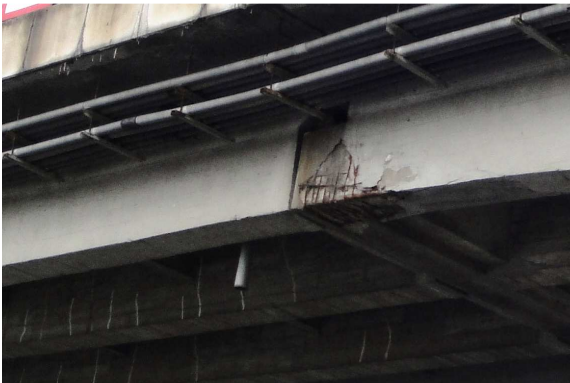
Fot. 22. Korozja odłoniętego zbrojenia dźwigara po stronie dolnej wody w obrębie przegubu w przęśle 3-4. Korozja zbrojenia w obrębie przegubu oraz odpadanie zaprawy naprawczej. W głębi naprawione pionowe rysy w konstrukcji podwieszanej.
