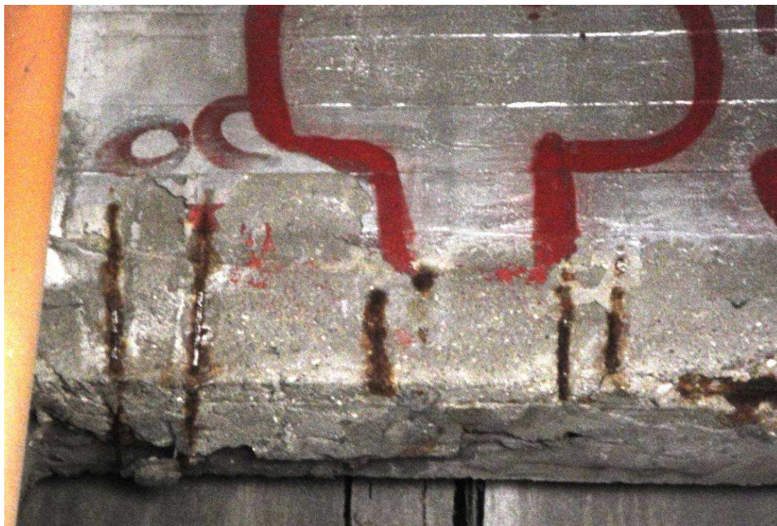
Fot. 28. Korozja zbrojenia w poprzecznicy skrajnej nad podporą 1.
