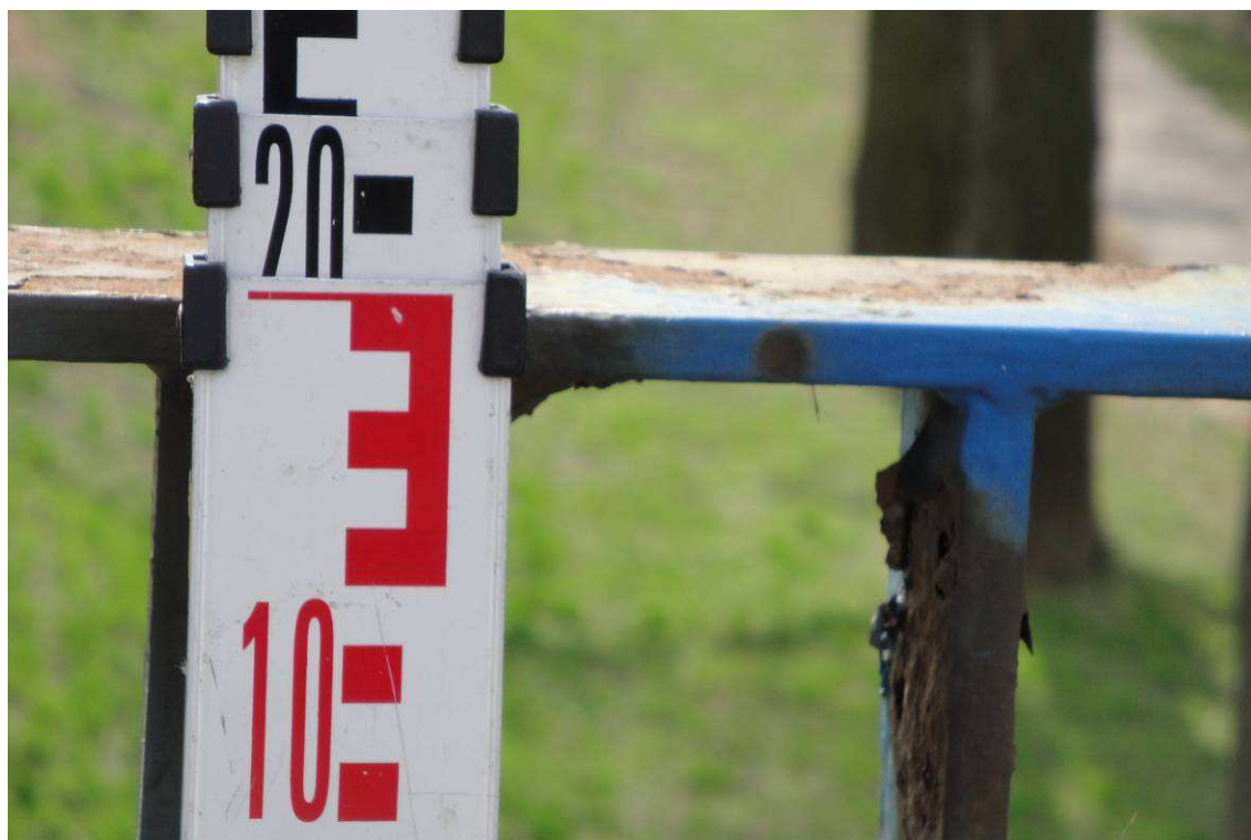
Fot. 12. Zaniżona wysokość. Korozja elementów balustrady. Stan typowy dla całej długości obiektu.
