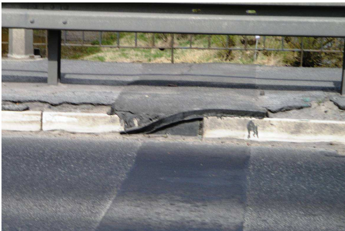
Fot. 14. Podłużne pęknięcia, ubytki i nierówności dylatacji bitumicznej zlokalizowanej w przęśle 7-8.
