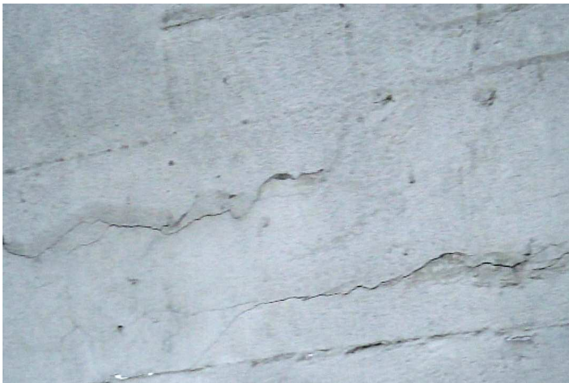
Fot. 26. Odspojenia otuliny wzdłuż prętów na bocznych powierzchniach dźwigarów głównych.
