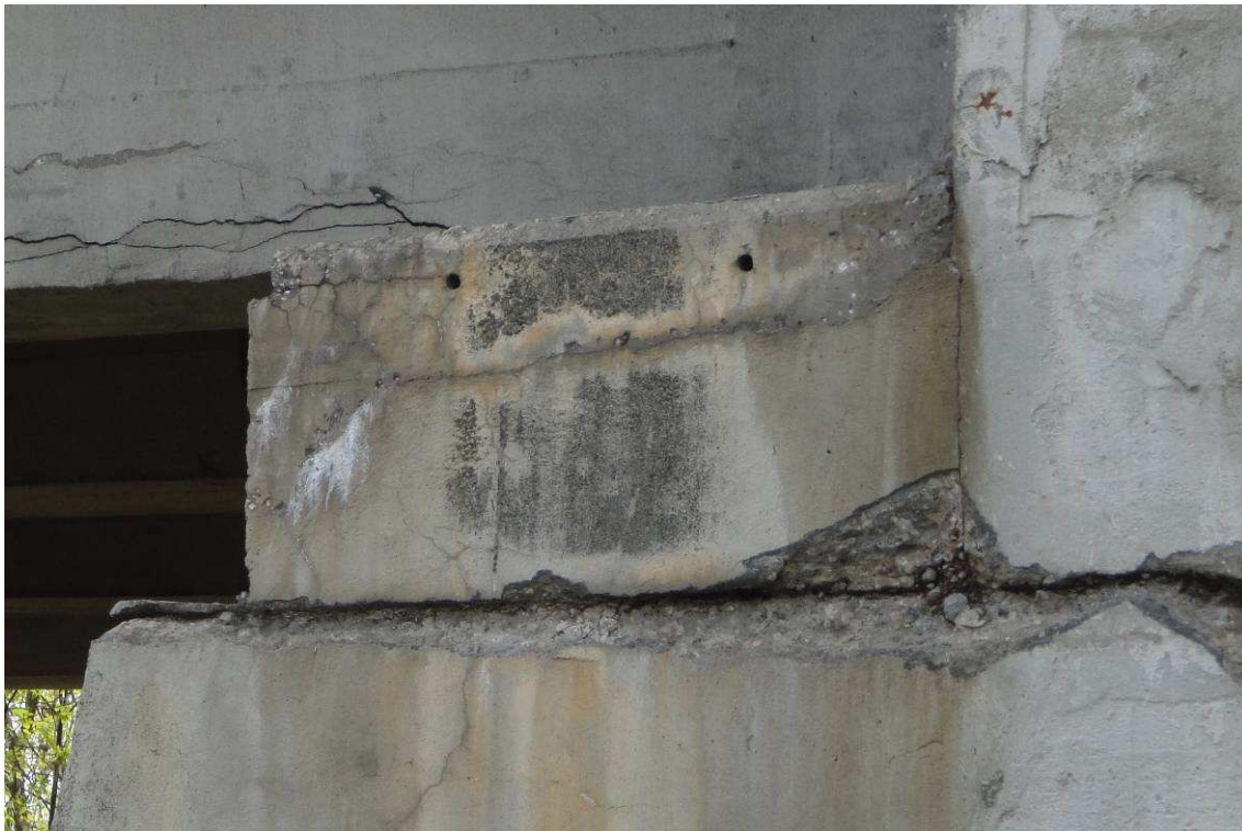
Fot. 32. Ubytki betonu ławy podłożyskowej przyczółka zachodniego. Destrukcja betonu spowodowana przeciekami w przerwie technologicznej na styku korpusu przyczółka i ławy podłożyskowej.
