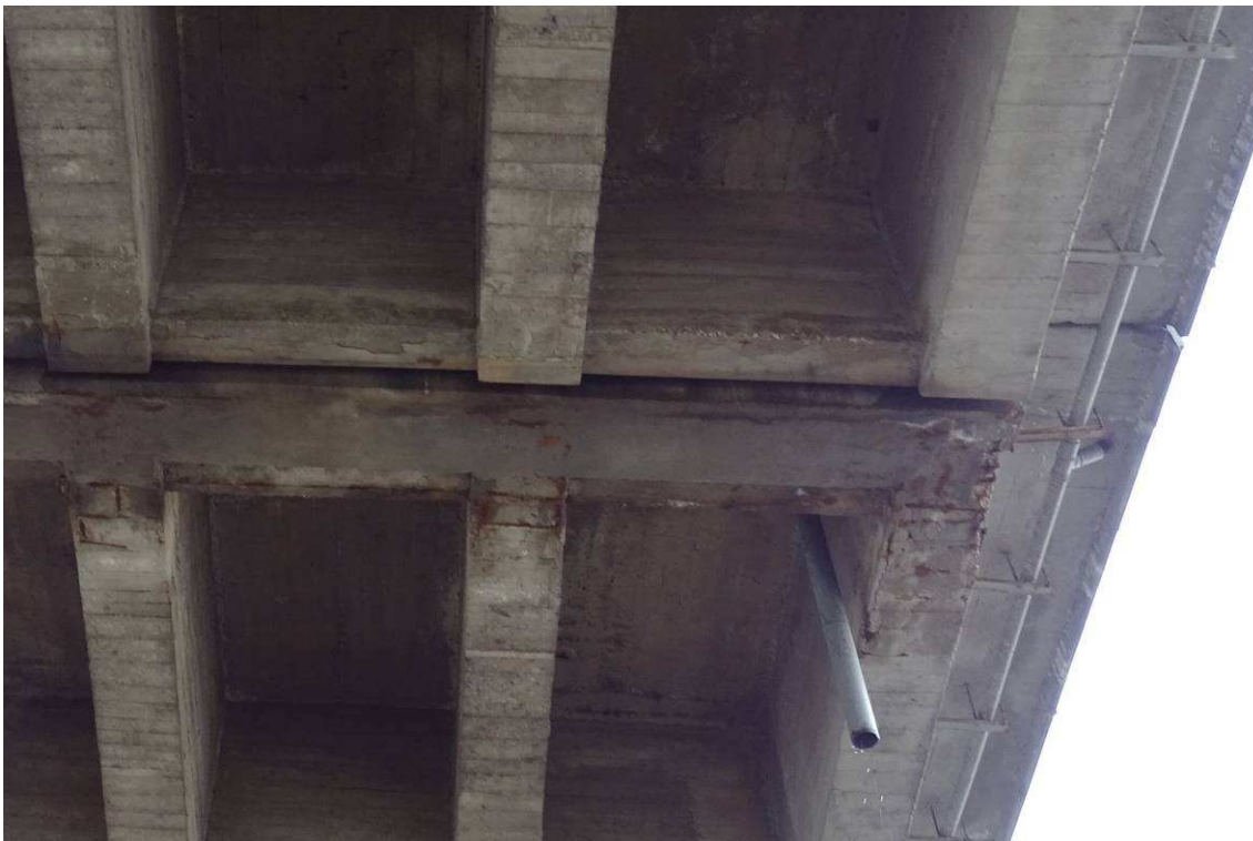
Fot. 21. Korozja odłoniętego zbrojenia dźwigara oraz poprzecznicy w obrębie przegubu w przęśle 3-4. Przecieki w dylatacji spowodowały korozję zbrojenia w obrębie przegubu oraz odpadanie zaprawy naprawczej.
