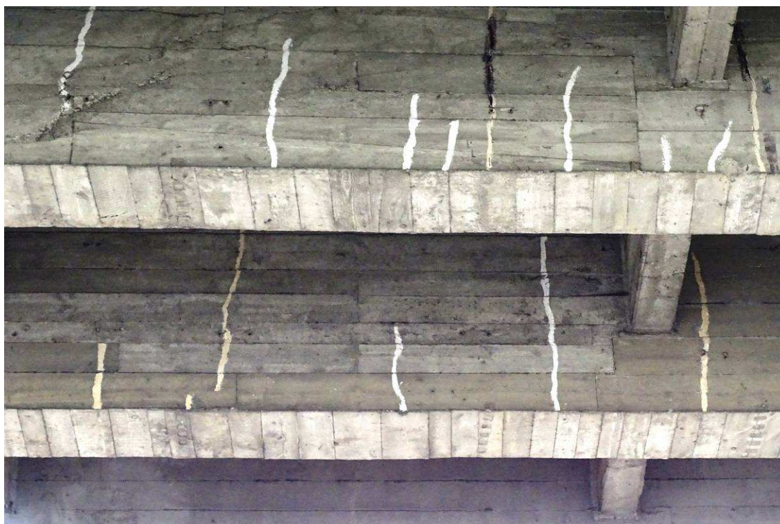
Fot. 29. „Raki” w miejscach przerw w betonowaniu w dźwigarze przęsta 2-3. Liczne ślady napraw rys wykonanych w trakcie remontu w latach '90.
