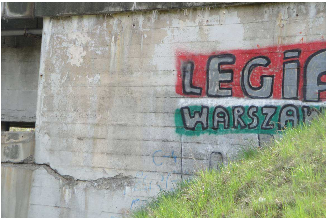
Fot. 34. Przyczółek zachodni. Spowodowana przez wymywanie destrukcja betonu i mas naprawczych wzdłuż poziomej rysy w miejscu technologicznej przerwy w betonowaniu w poziomie podstawy ławy podłożyskowej.
