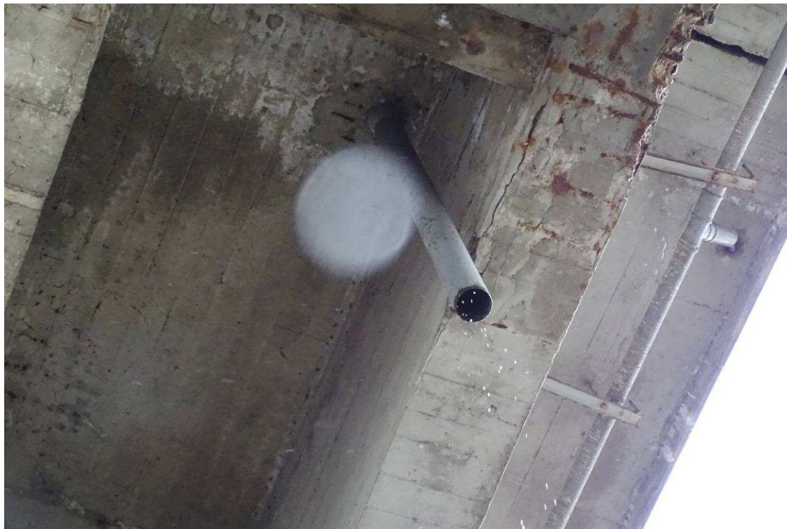
Fot. 18. Skorodowana i zniszczona konstrukcja dźwigara i płyty wokół wpustu.
