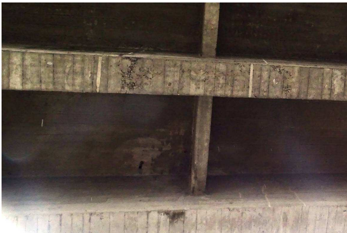
Fot. 24. Niedowibrowany w trakcie budowy i nigdy nie naprawiany beton dźwigarów w przęśle 4-5. Przecieki wokół sączków oraz miejscowe przecieki w obrębie płyty.
